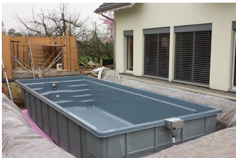
Versetztes Becken auf Bodenplatte
